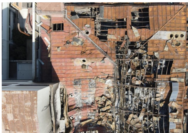
火災後の建物上部の様子
