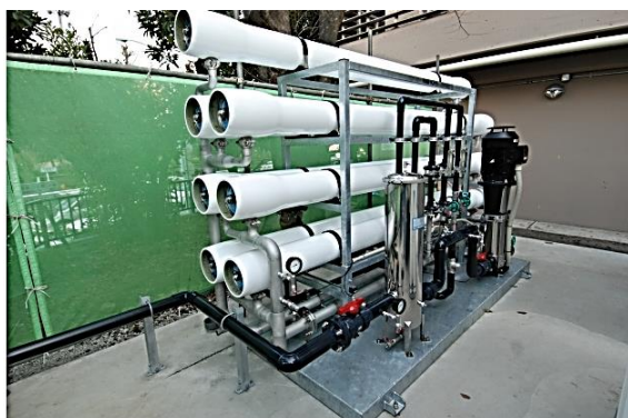
井戸水を利用した地下水膜ろ過システム
